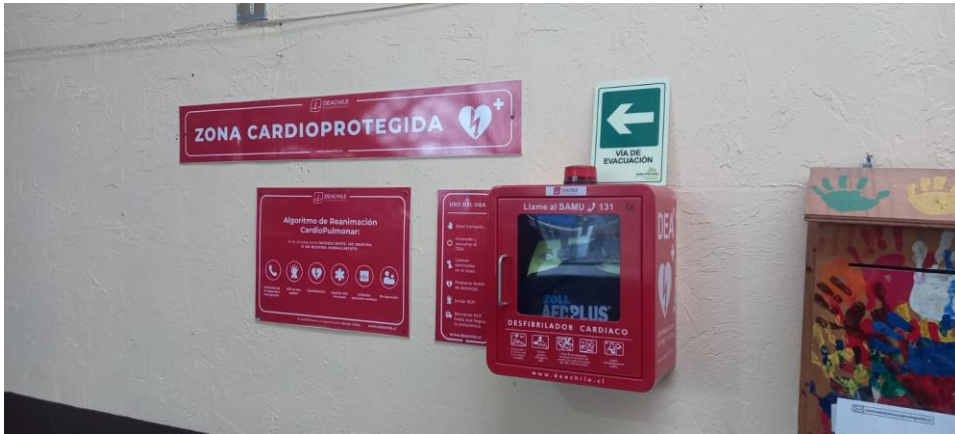
Imagen 1 muestra DEA ubicado en pasillo de Media.
